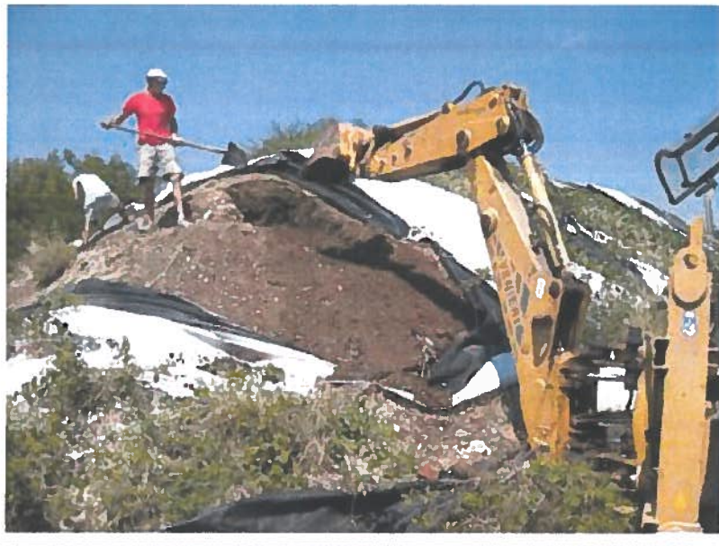
Figura 11: Esecuzione di scavi nel cumulo per il prelievo degli incrementi superficiali e profondi per la formazione dei campioni di rifiuto
